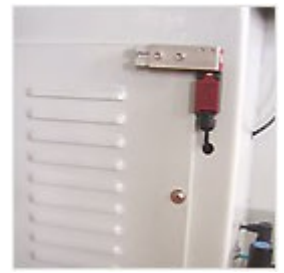
Sähkökaapin virran katkaisu
